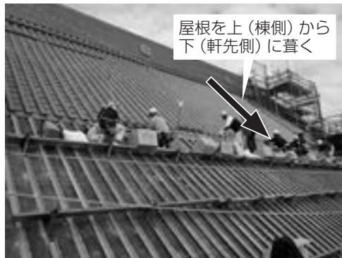
屋根を上（棟側）から下（軒先側）へ葺く「バックキング工法」は、コスト、安全、美観面に優れている
